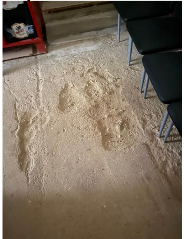
Abbildung 109: brüchiger Fußboden in der Fahrzeughalle
