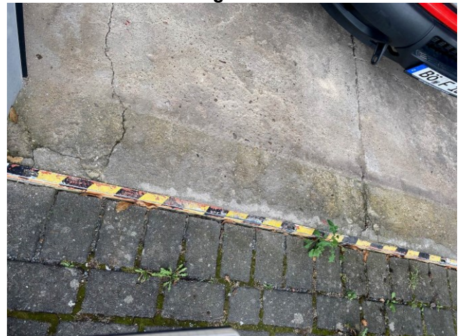
Abbildung 105: Kante an der Torausfahrt mit Rissen im Boden
