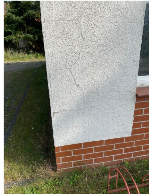
Abbildung 104: Risse in der Fassade
