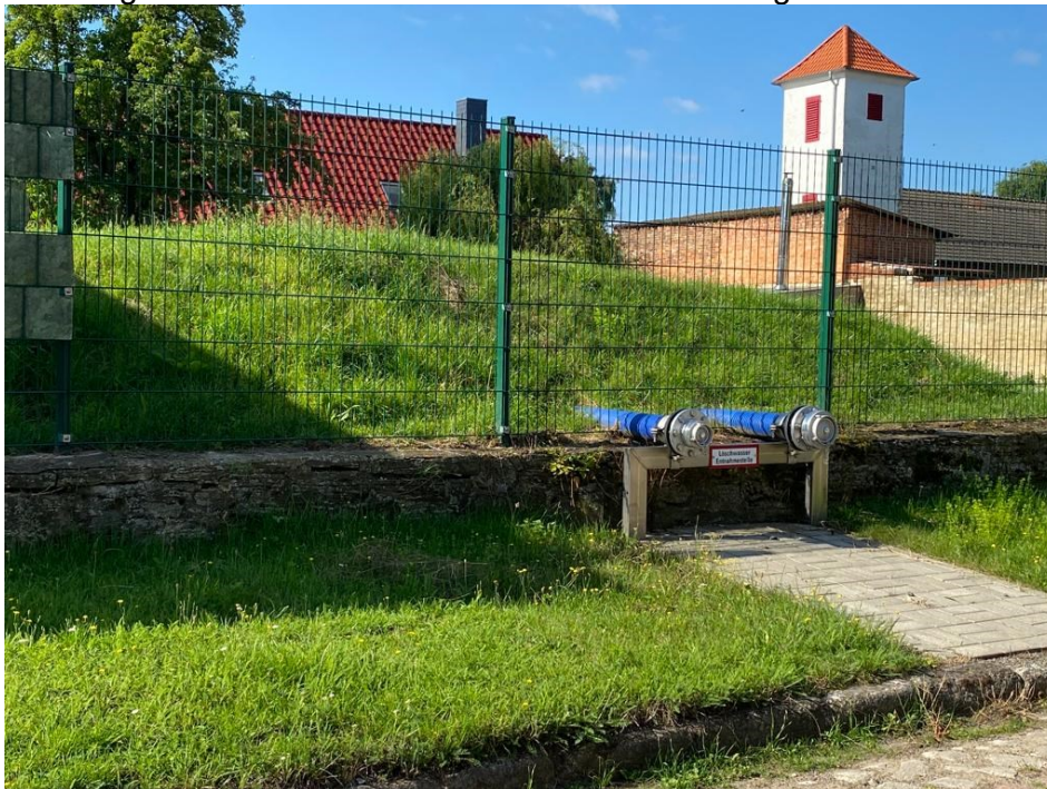
Abbildung 10: unterirdischer Löschwasserbehälter in Dalldorf
