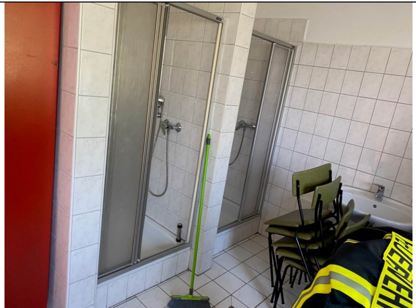
Abbildung 100: Dusche im Feuerwehrhaus in Neuwegersleben
