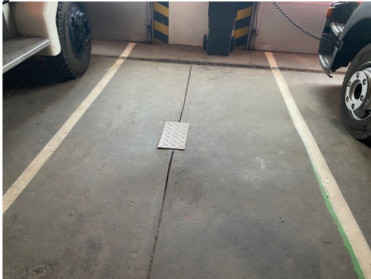
Abbildung 157: Der Fußboden in der Fahrzeughalle wölbt sich, als Behelfslösung wurden Schnitte in den Fußboden gesetzt.
