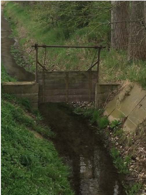
Abbildung 24: Stauwehr als Löschwasserentnahmestelle am Ortsausgang Richtung Wackersleben, im Juni 2017
