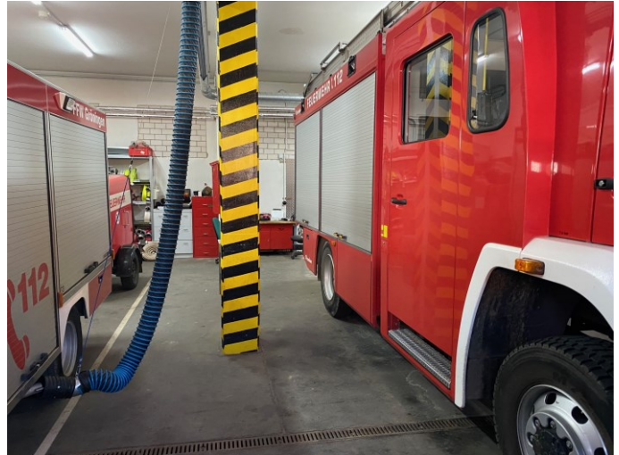
Abbildung 140: bauliche Hindernisse, wie in diesem Fall die Stützen sind mit einer Warnmarkierung versehen, ebenfalls zu sehen sind die Ladeerhaltungen und Abgasabsauganlage, sowie die Markierungen auf dem Hallenboden für die Fahrzeugstellplätze
