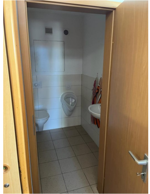
Abbildung 118: Toilette und Handwaschmöglichkeit im Feuerwehrhaus
