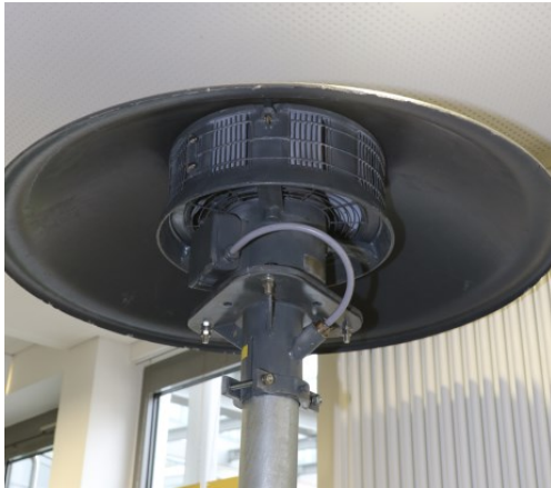
Abbildung 70: elektromechanische Sirene in der verbreiteten Bauform in der Westlichen Börde Quelle: Bundesamt für Bevölkerungsschutz und Katastrophenhilfe
