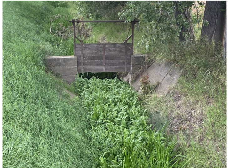
Abbildung 25: keine Löschwasserentnahme mehr möglich im August 2023
