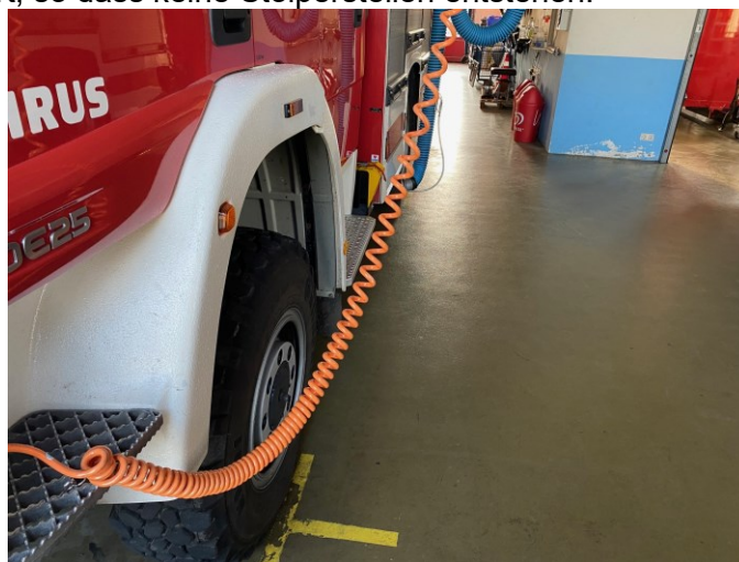
Abbildung 126: Abgasabsaugungen und Ladekabel werden von oben an die Fahrzeuge herangeführt.
