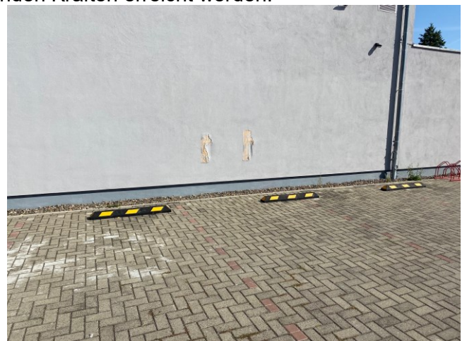
Abbildung 138: um weitere Anprallschäden zu vermeiden, wurden Parkplatzbegrenzer eingebaut.
